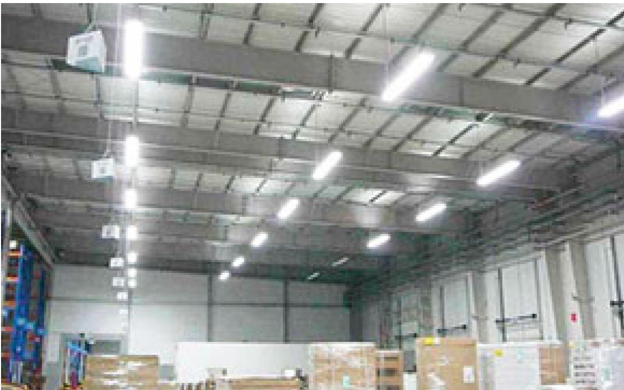
Abb. 19: Beleuchtungsanlage des Zwischenlagers
