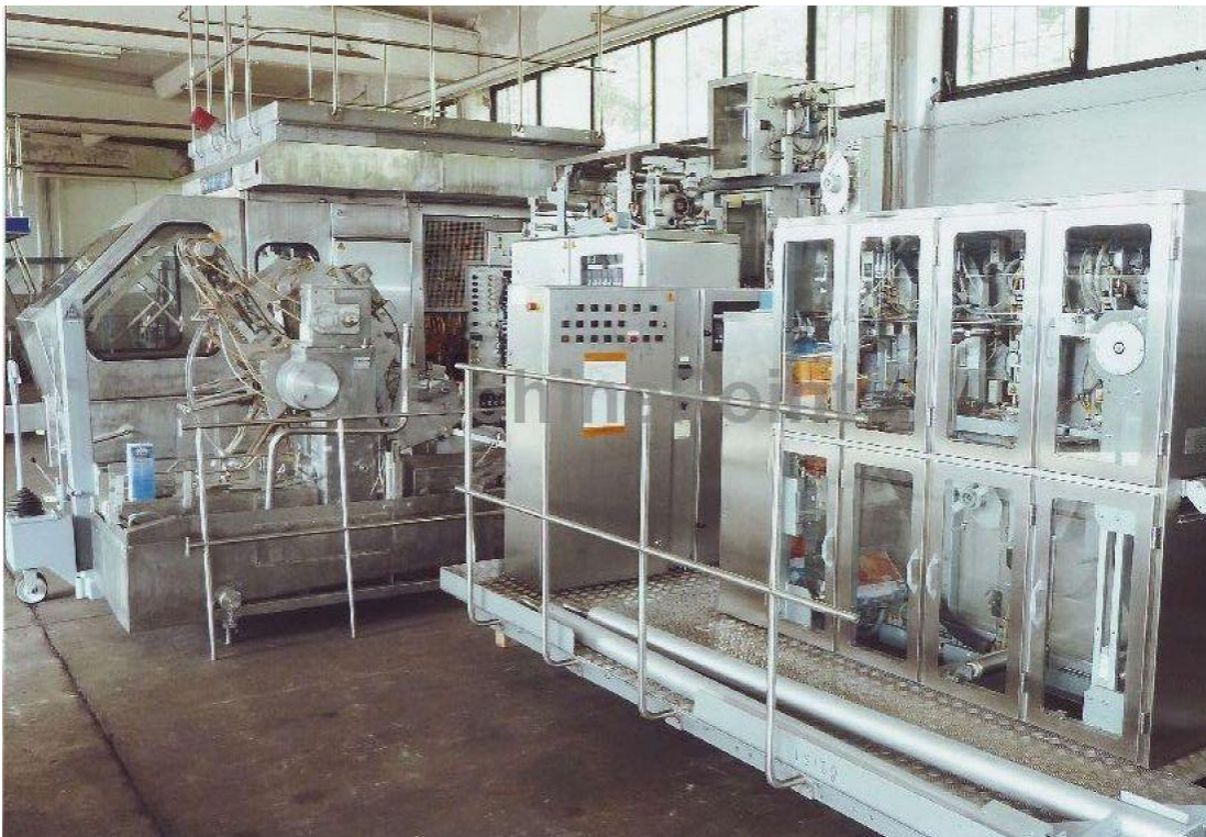
Abb. 21: Aktuelle Klimaanlage der Produktionsabteilung
