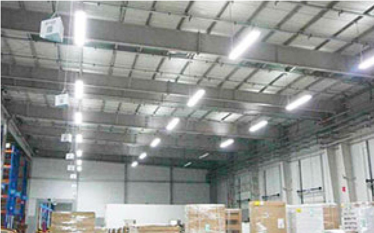
Abb. 7: Beleuchtungsanlage des Zwischenlagers
