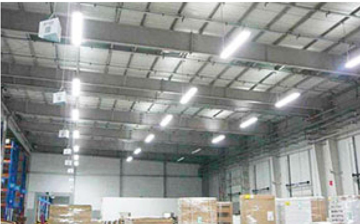
Abb. 20: Beleuchtungsanlage des Zwischenlagers
