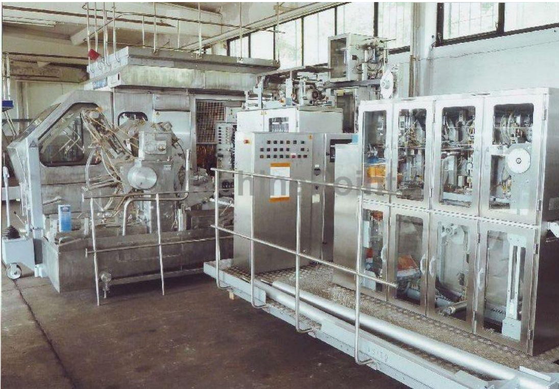
Abb. 10: Aktuelle Klimaanlage der Produktionsabteilung
